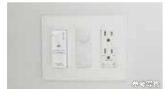
マルチメディアコンセント
